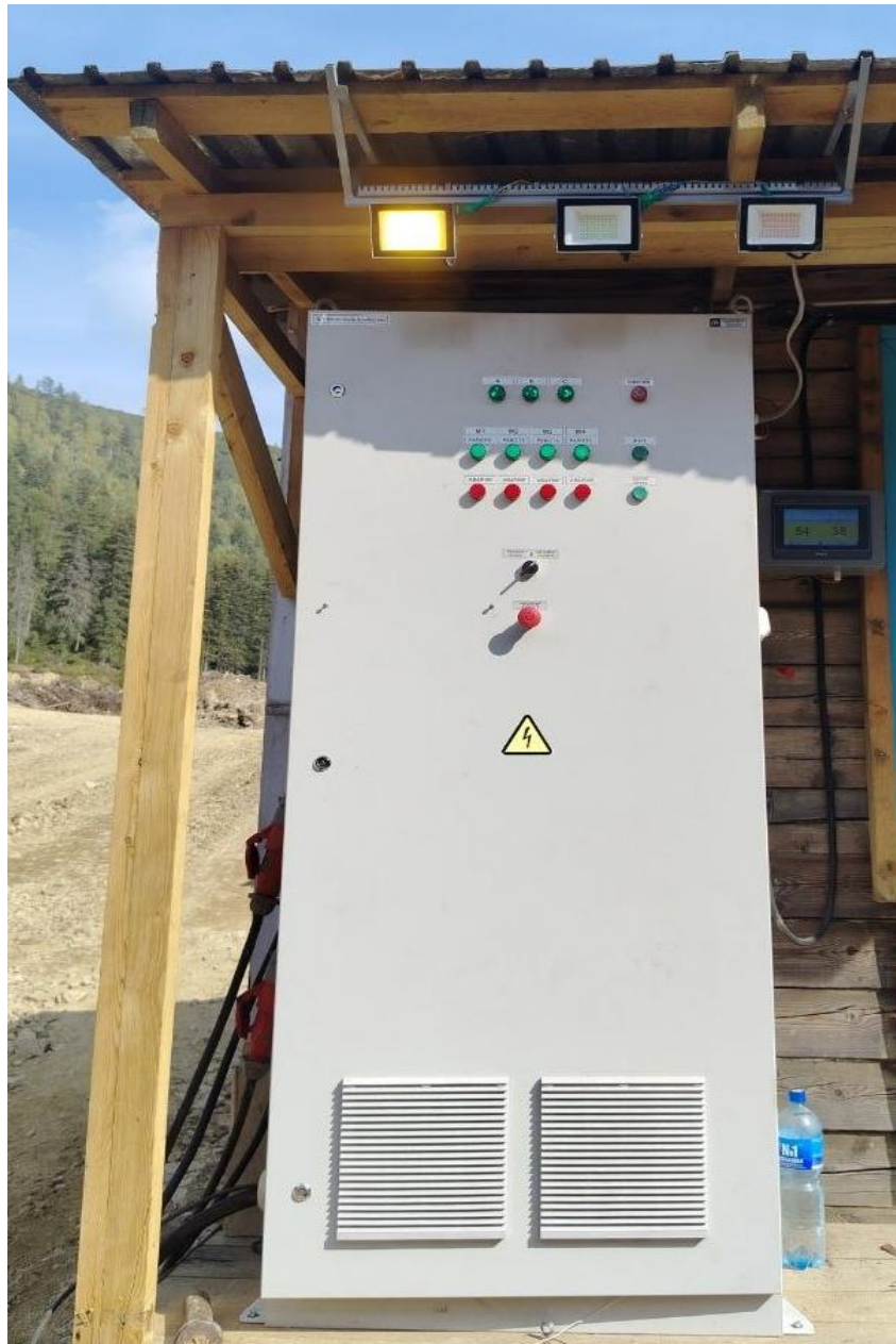
Рисунок 3.2 – Шкаф управления системой автоматизированного регулирования с сигнальной колонной
